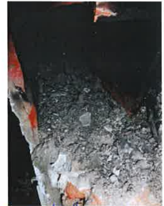
Conduit cheminée sous vide
